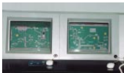
Telas de operação na nova sala de controle
