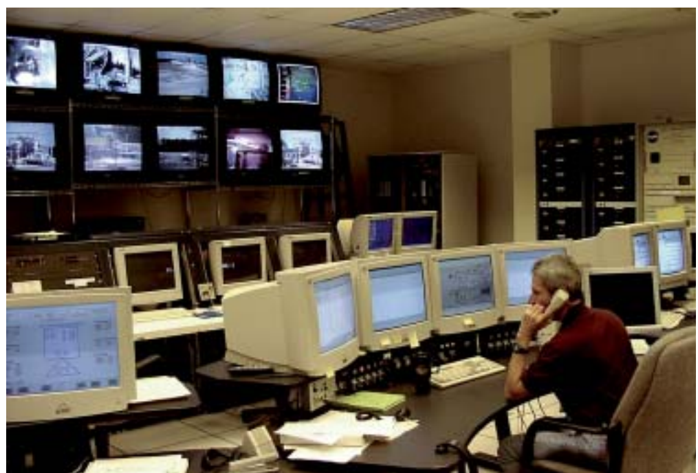
Antes do advento da arquitetura comum, diferentes sistemas de controle em cada uma das três salas de controle tornavam difícil para os engenheiros passarem para outros locais de projeto quando necessário
