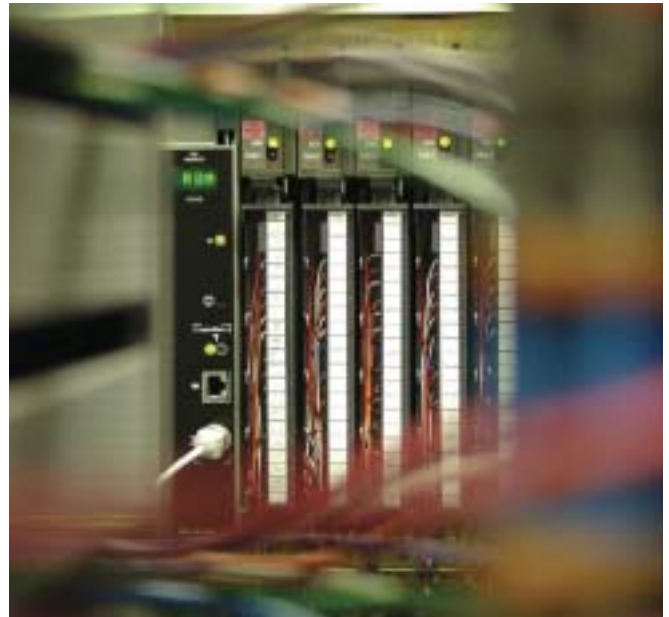
Esse rack remoto CLP-5 na instalação E2/Cell-1 é um dos dois ligados entre si por meio da ControlNet, fornecendo controle em tempo real sobre os pontos de E/S no campo e na sala de controle
